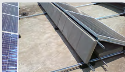
Photovoltaik-Anlage auf massivem Flachdach (1,6 MWp)
